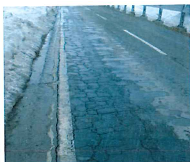
道路舗装の凍上被害
